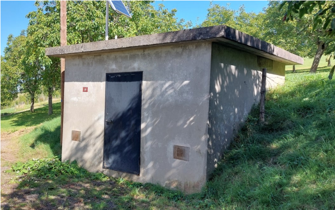
Un modeste cabanon mais qui cache en réalité le château d'eau où est stockée l'eau puisée par la commune.
